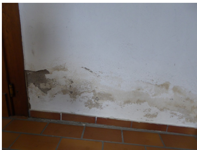
Beispiel von im Frühjahr 2021 erkennbaren Schäden im Innern der Kapelle
